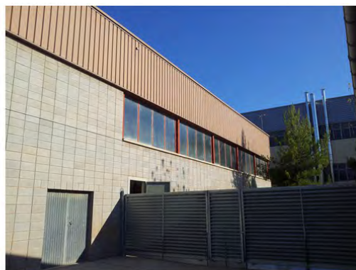
Façana Sud. Accés sala calderes Només manteniment
